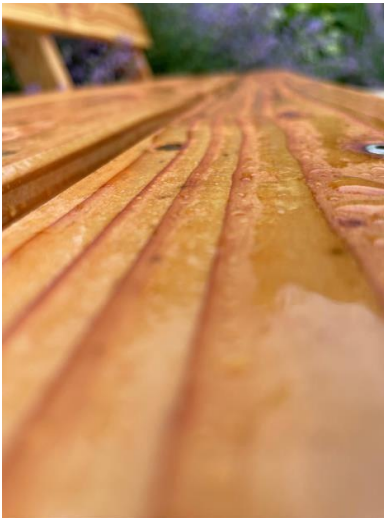
Wasser dringt in das Holz ein
